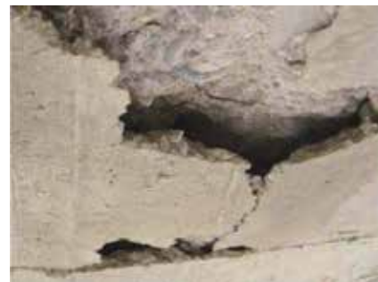
床版下面の剥離
