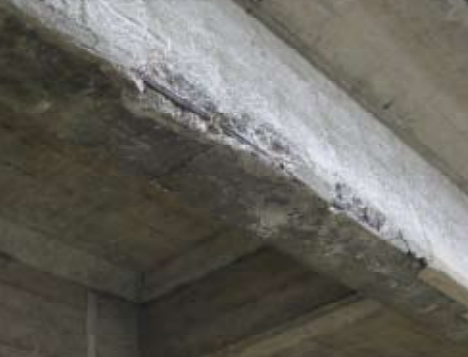
ASR被害状況
